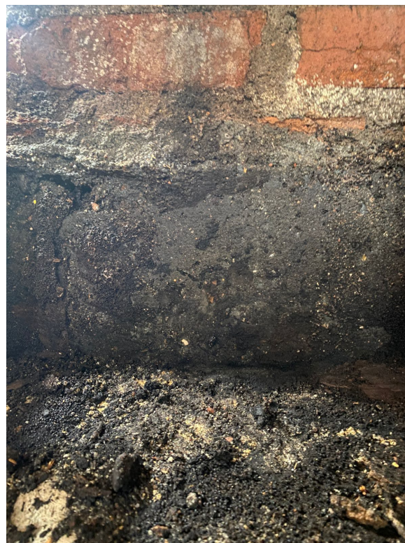
07. Situação no topo da alvenaria, vazio ao lado do frechal.
