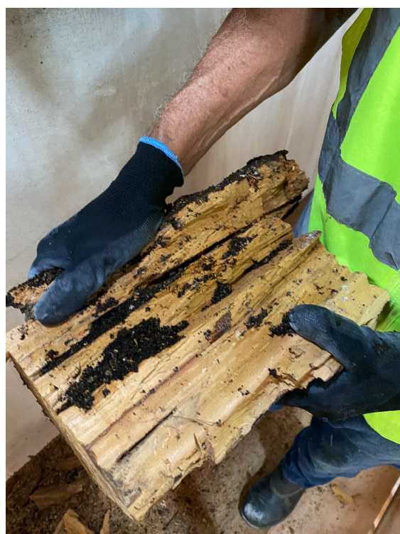
09. Inspeção das pelas de madeira com ataque de xilófagos.
