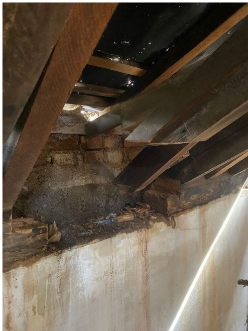
34. Identificação de parte do frechal peças para substituição.
