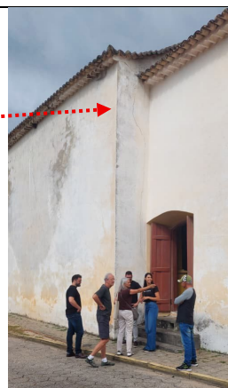
08. Face externa da fissura, na fachada lateral junto à rua,
