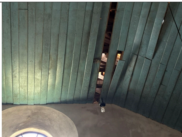
05. Detalhe da situação do forro saia-e-camisa da nave, com peças faltantes e peças parcialmente soltas e despregadas, com risco de queda
