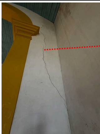
07. Detalhe da fissura no interior da nave, ao lado direito do arco cruzeiro.
