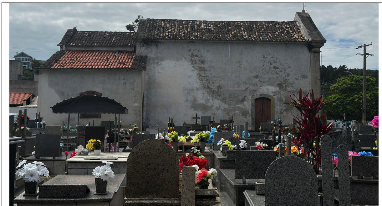
16. Estado de conservação da fachada lateral – observar a vegetação de grande porte na cobertura da nave – origem das raízes no seu interior.
