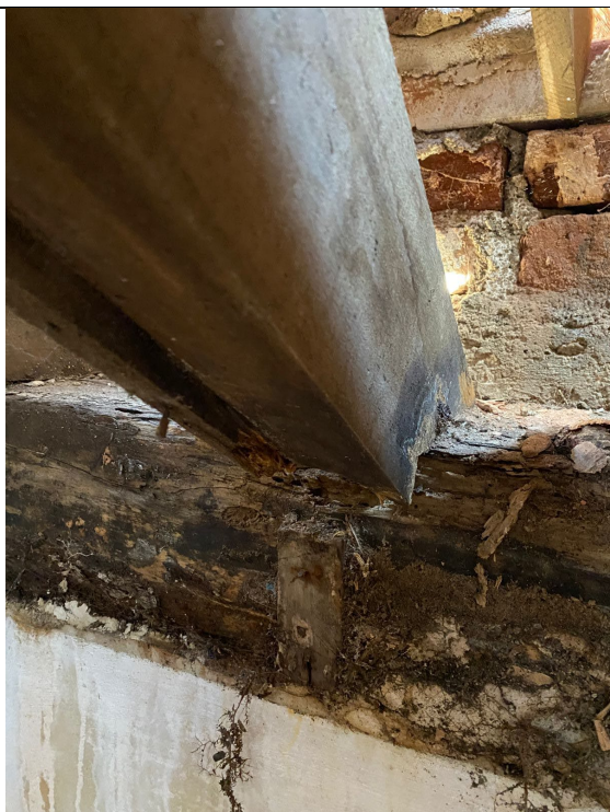
95. Detalhe do apoio da perna do caibro sobre o frechal de madeira apodrecidos.
