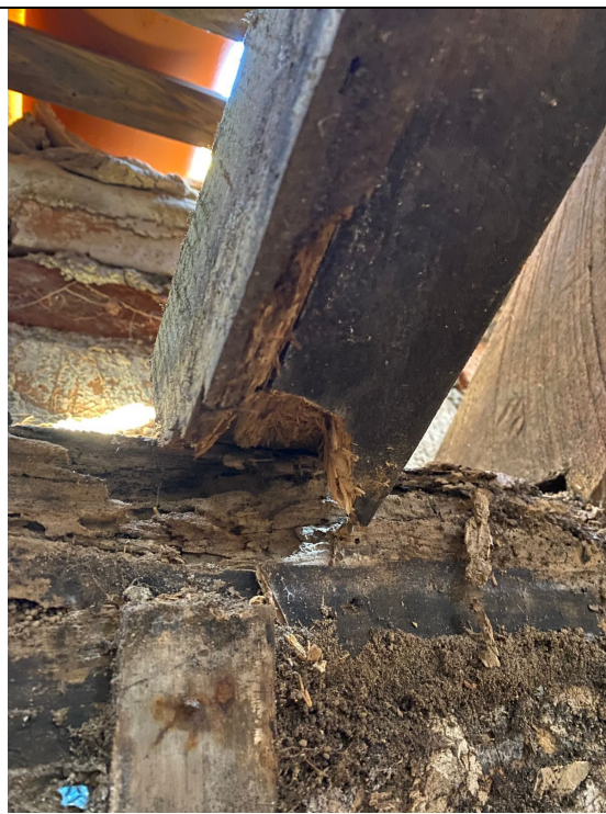
96. Detalhe do apoio da perna do caibro sobre o frechal de madeira apodrecidos.
