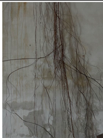
06. Detalhe das raízes infiltradas na nave, oriundas da vegetação externa na cobertura.
