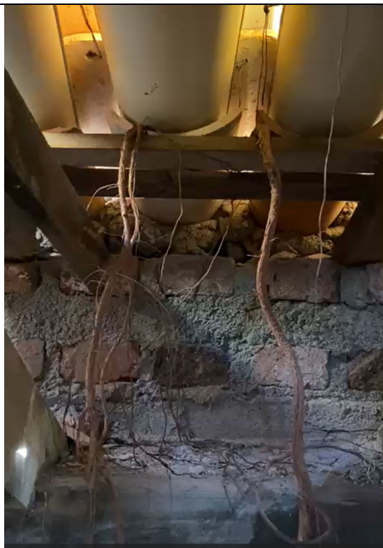
97. Invasão das raízes da vegetação sobre a cobertura, descendo pela face interior da edificação.
